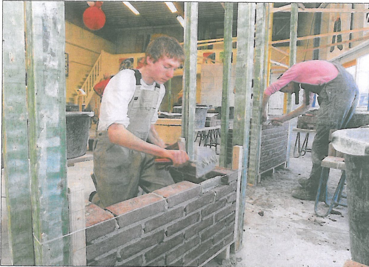
Wouter Elijzen uit Klarenbeek metselt aan een buitenbarbecue. „Een leuke opdracht. Nooit eerder gemaakt, maar je probeert toch vakwerk af te leveren”, zegt Elijzen. foto Cees Baars
